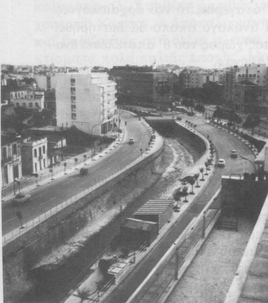
13. Ἡ Λεωφόρος Καλλιρρόης κατὰ τὴν ἐκτέλεση τῶν ἔργων καλύψεως τοῦ Ἴλισσου (Φωτ. Ι.Κ. τοῦ 1965).
