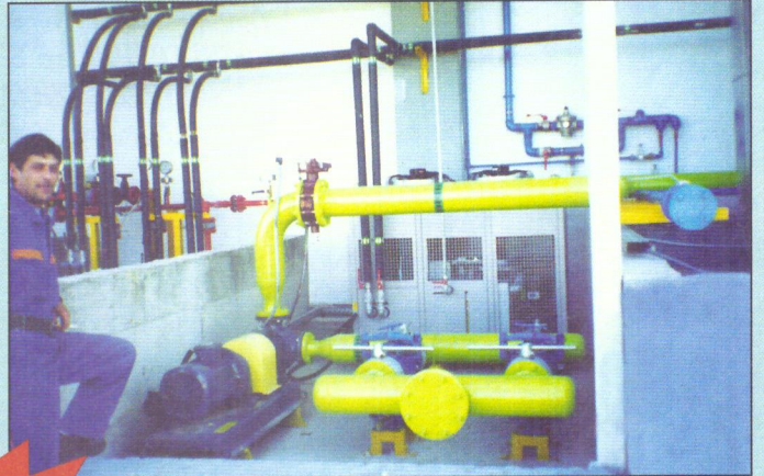
ΕΓΚΑΤΑΣΤΑΣΗ ΚΥΚΛΟΠΕΝΤΑΝΙΟΥ ΣΤΗΝ ΒΙΟΜΗΧ. FRIGOGLOSS
